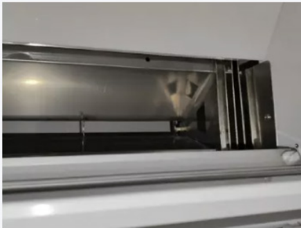
Sistema de control del polvo
